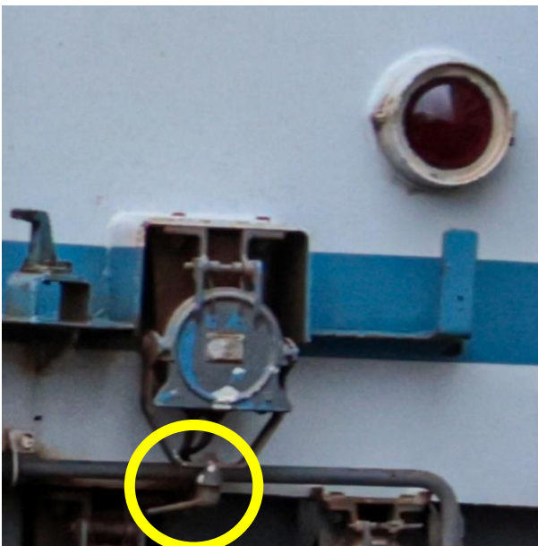
← 丸がついているところが保温用ヒーター
