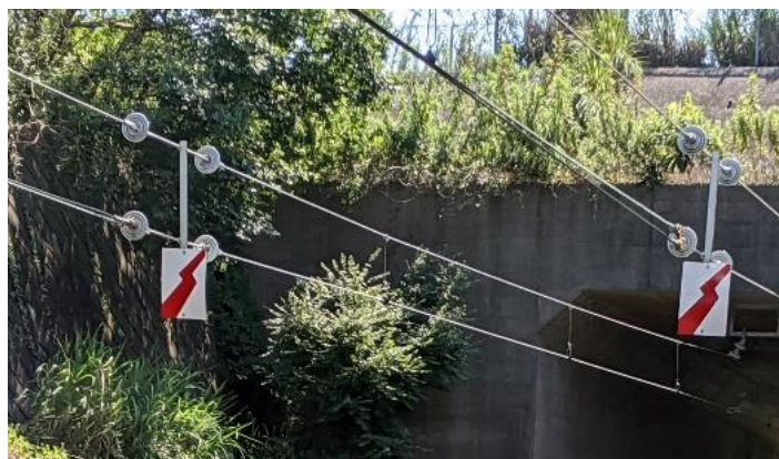
架線終端標識
