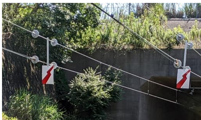
架線終端標識
