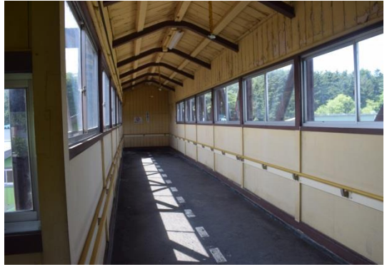
▲虫だらけの跨線橋内部
