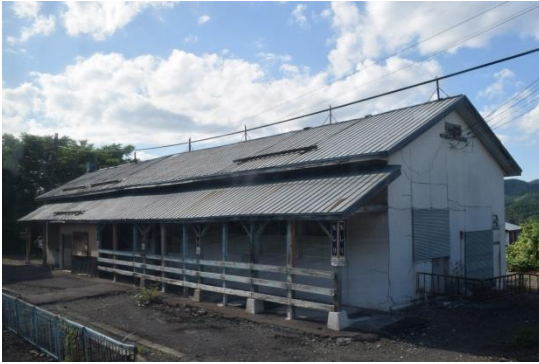
▲茂尻駅の木造駅舎。腐食化が進んでいる
