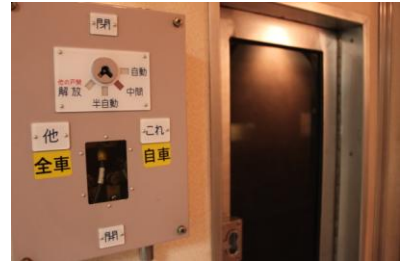
▲通路にあるドア開閉スイッチ。
